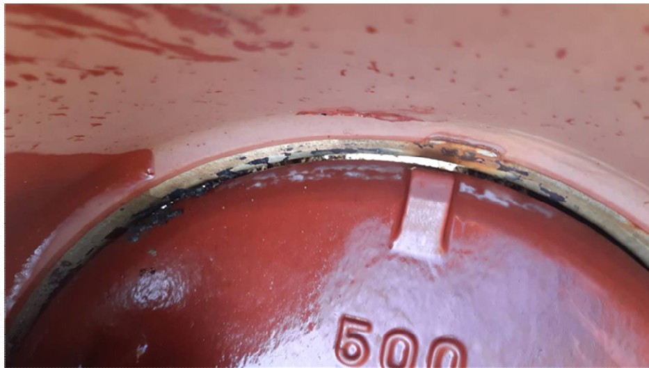
PWN: Foto van een vervangen afsluiter waarbij de afdichtingsring is verdwenen.
