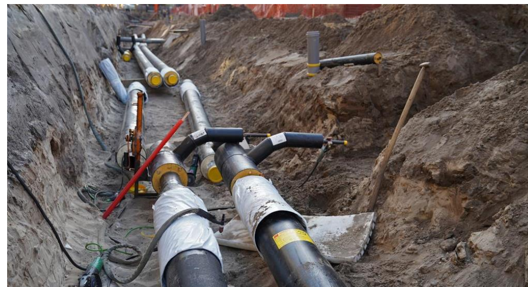
Corrosie door zuurstofintrede is vooral een risico bij PE-PUR-staal leidingsystemen die doorgaans gebruikt worden voor MT-warmtenetten, maar soms ook voor LT-warmtenetten. Bron: hieropgewekt.nl [14].
