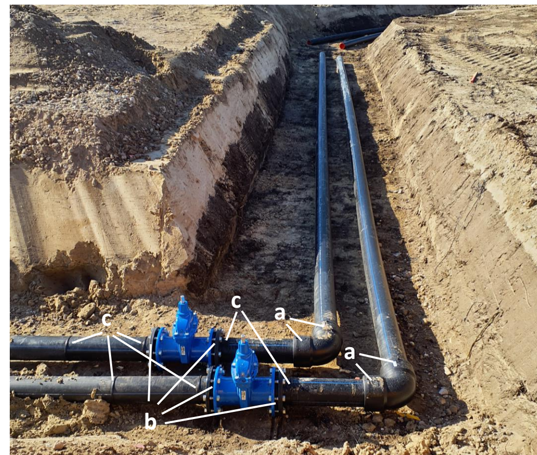
Voorbeeld van een nieuw gelegd 2-pijps ZLT-warmtenet bestaande uit reguliere drinkwater PE100 leidingen met elektrolas verbindingen bij de bochtstukken (a), flensverbindingen bij de afsluiters (b) en stuiklas verbindingen tussen de leidingen (c). Bron: Heijmans Infra.
