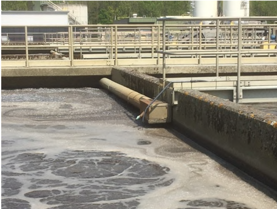
Dosering van het duurzame vlokmiddel in een beluchtingsstraat van de rioolwaterzuivering Bath (Waterschap Brabantse Delta)
