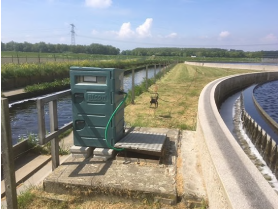
Systeem voor automatische monsternamen elke 24 uur in het in- en effluent
