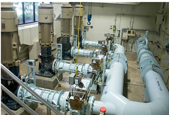
Met asset health is de mate van functie-uitoefening van een hogedrukpompinstallatie uit te drukken in één getal.
