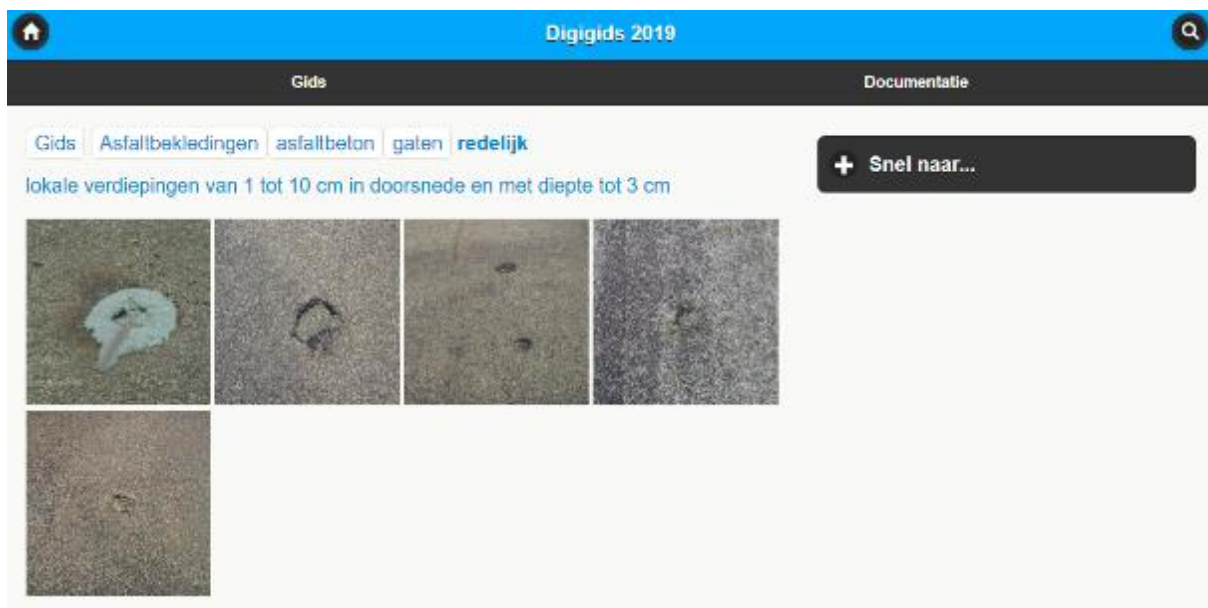
Figuur 11 Voorbeeld van de STOWA Digigids voor waterkeringen, waarbij illustratieve foto's zijn opgenomen voor asfaltbekledingen, van asfaltbeton, het schade beeld 'gaten', met de classificatie 'redelijk'.
