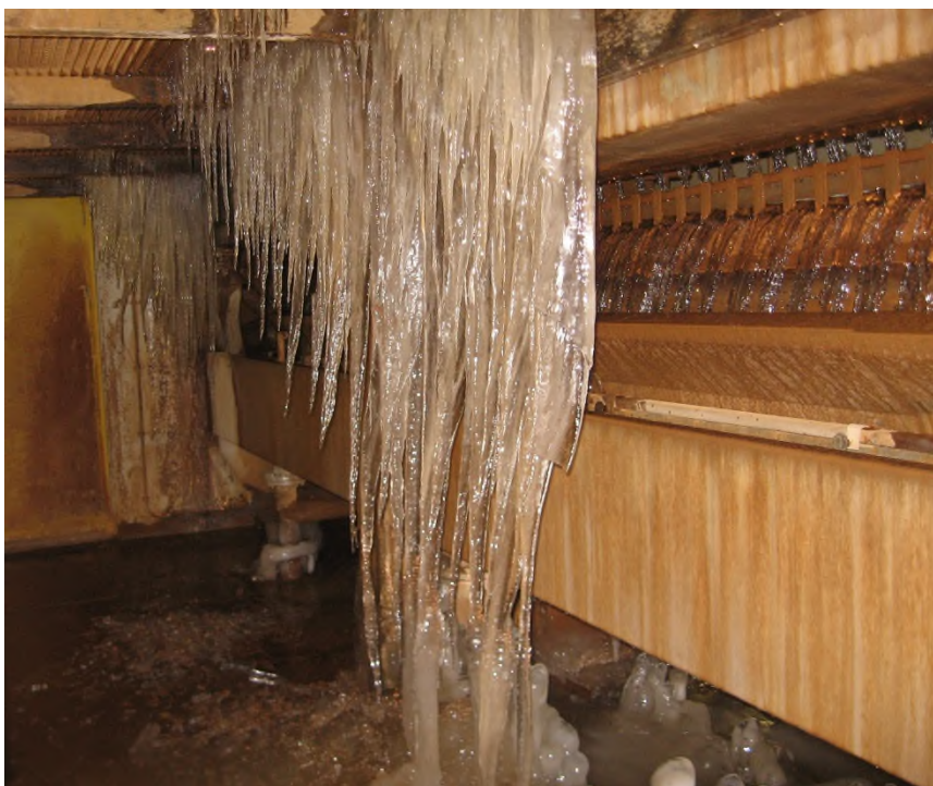
Foto 5 Bevriezing van een cascadebeluchting door ijskoude buitenlucht (foto Evides Waterbedrijf).
