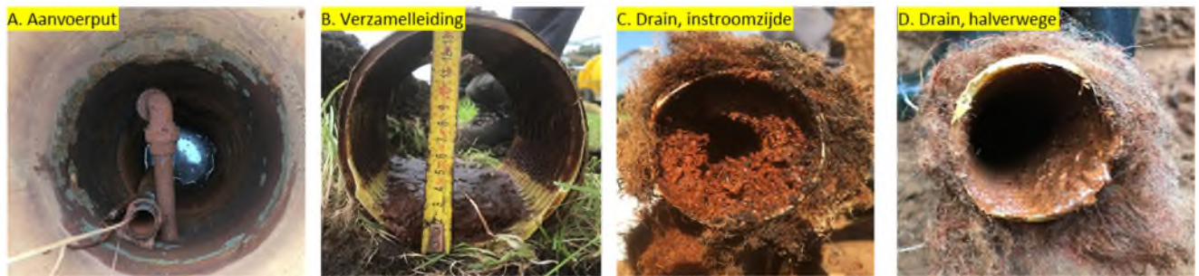
Figuur 5-2: Biofilm in de aanvoerput (A) verzamelleiding (B), instroomzijde drain (C) en drain halverwege het systeem (D) van America.
