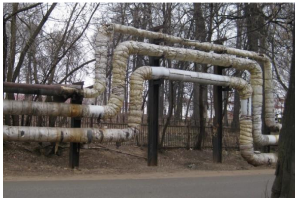
Figuur 3 Tweede generatie warmtenet , bovengronds aangelegd met kenmerkende expansielussen
