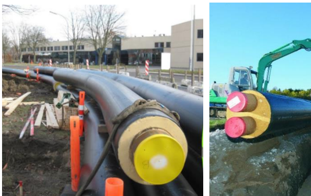
Figuur 4 Leidingen van een derde generatie warmtenet , waarbij rechts sprake is van een zogenaamde duo-pijp waarbij de heen en retourleiding in één buis zijn samengebracht.
