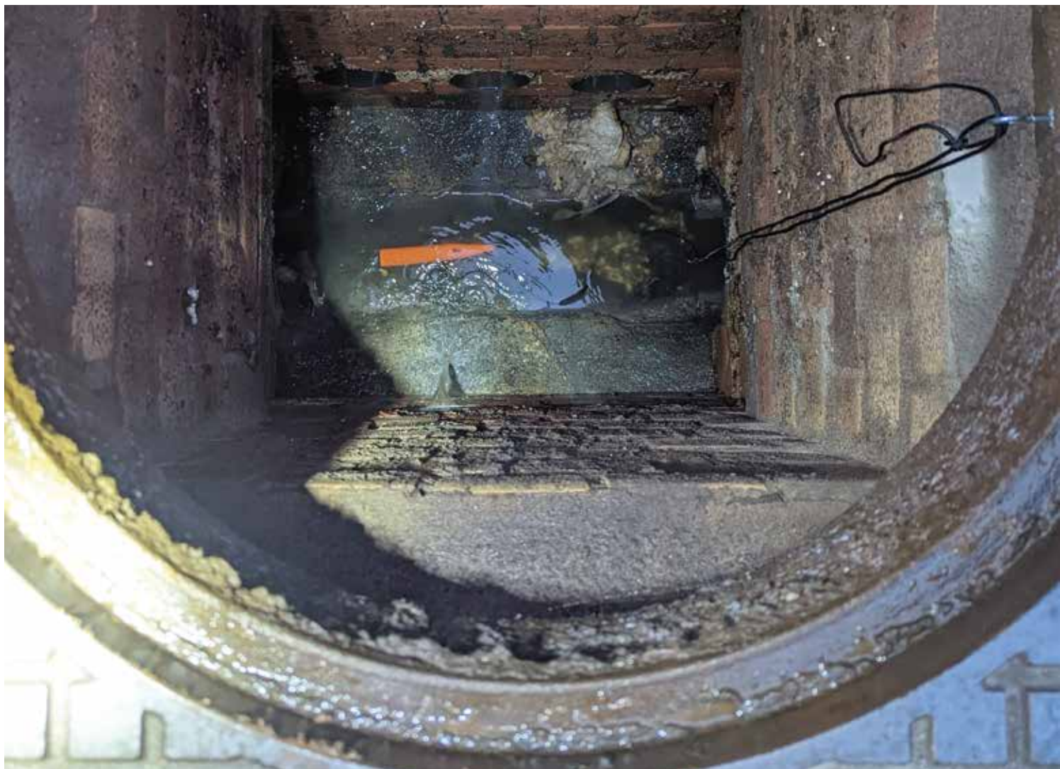
Een passive sampler die zojuist in het riool is geplaatst
