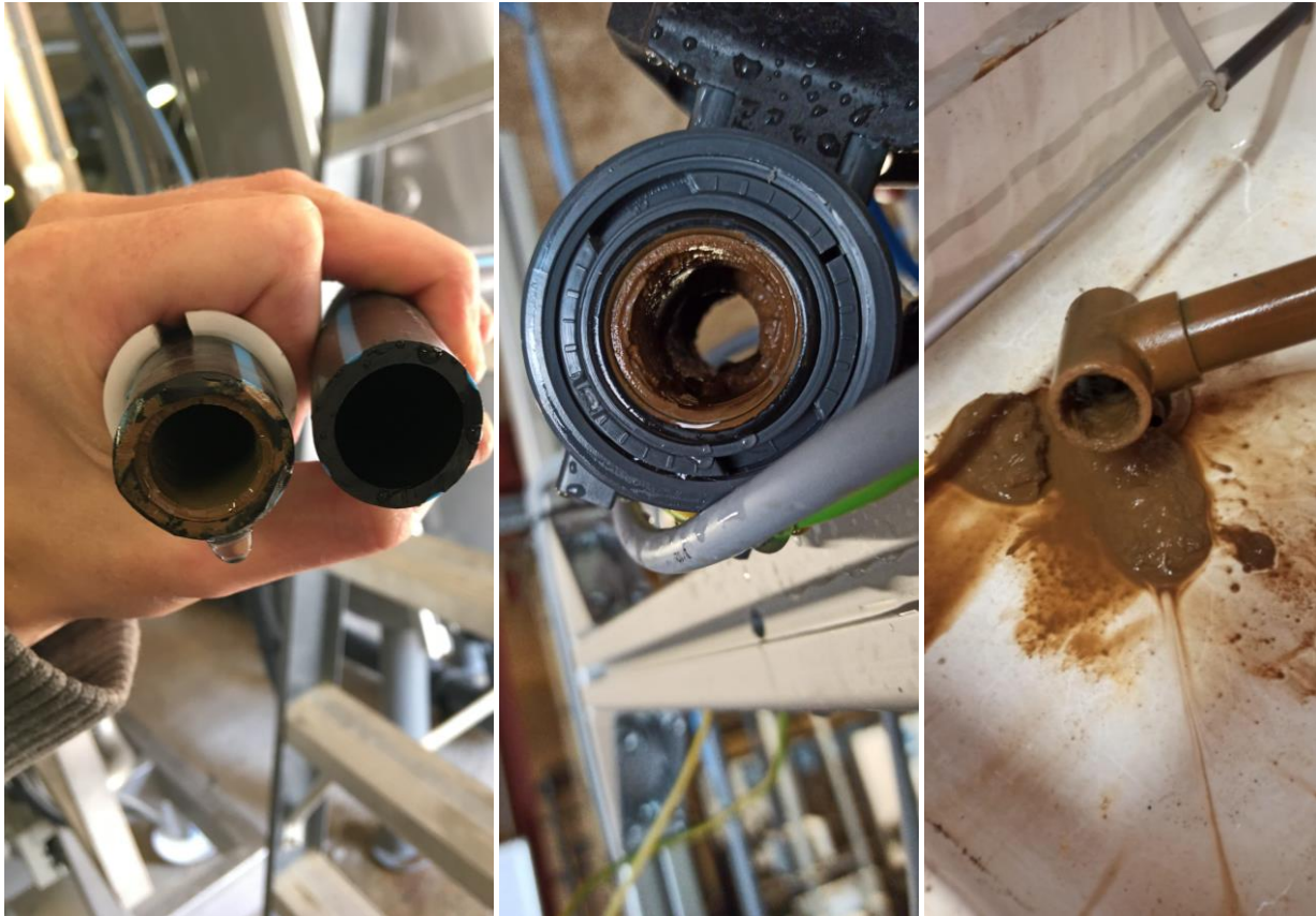
Figuur 4: visualisatie van de vervuiling met hoofdzakelijk ijzeroxiden in de PE aanvoerleiding en het PVC leidingwerk op/in het zandfilter. De meest rechterfoto laat het t-stuk zien waardoor het beluchte RO concentraat horizontaal in de filterketel wordt ingebracht
