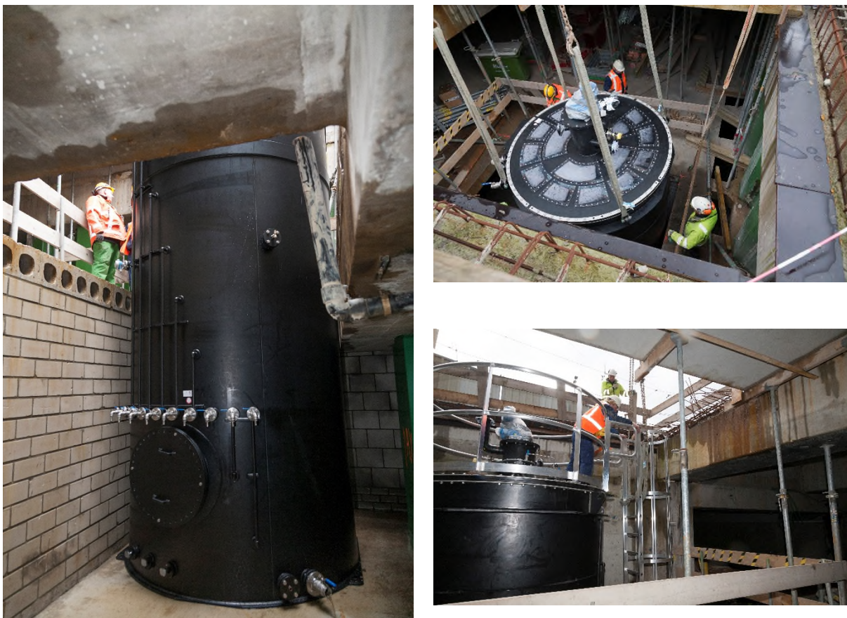
Figuur 6: Plaatsing van een vergister in een parkeergarage in Den Haag.
