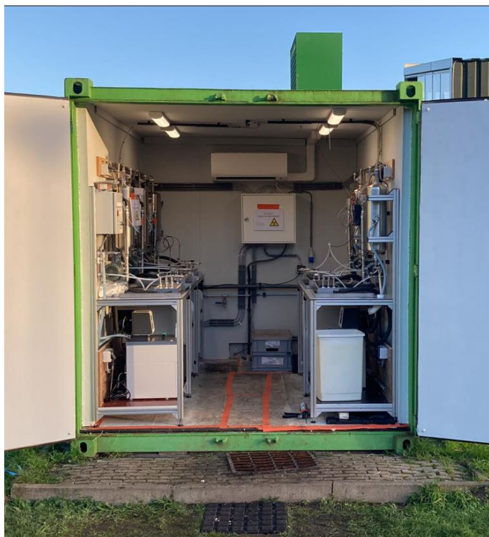
ZOB-container van PWN waarin de flowcellen waren geïnstalleerd geplaatst op locatie
