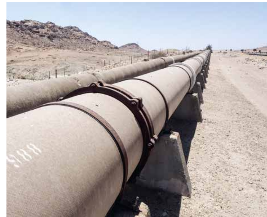
Een grote gastransportpijpleiding door de woestijn
