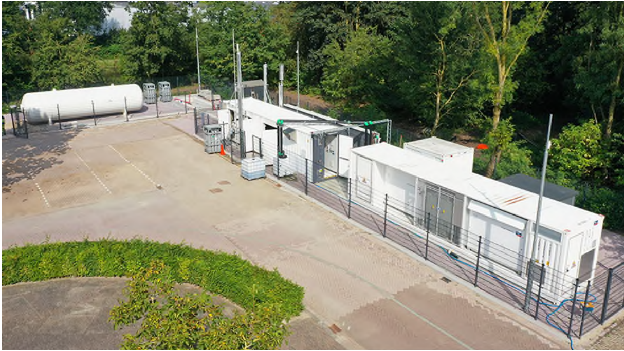
De productielocatie voor groene waterstof staat op het terrein van KWR in Nieuwegein | Foto Hysolar
