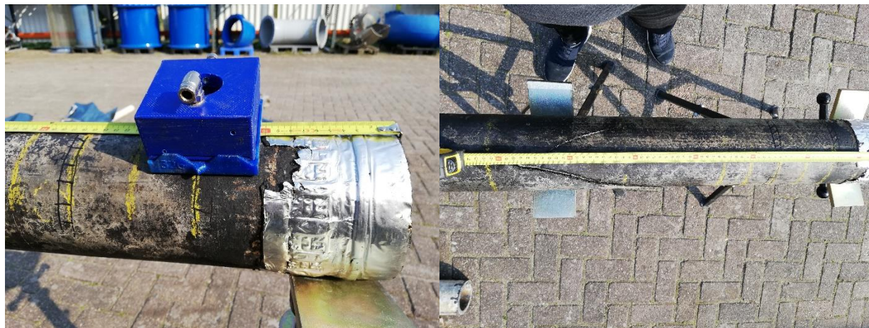
Figuur 1: Links: foto van de PipeScanner op de buis waarop de afstand t.o.v. het einde van de buis, de bandbreedte van de PipeScanner en de omtrek richting van de PipeScanner te zien is. Rechts: foto van de gehele buis waarop de scheur te zien is.
