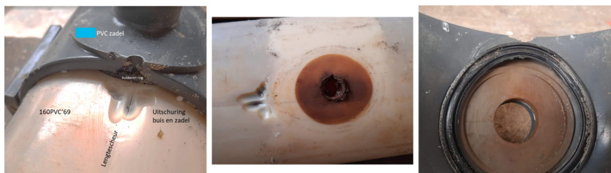
Figuur 31: (Links) Uitschuring van de buiswand direct naast het zadel. Op één locatie is de hele buiswand weggescheurd en vormt het initiatiepunt van een lengtescheur. (Midden) Lengte scheur met als initiatiepunt de plek waar de buiswand is uitgescheurd. (Rechts) Binnenkant PVC aanboorzadel
