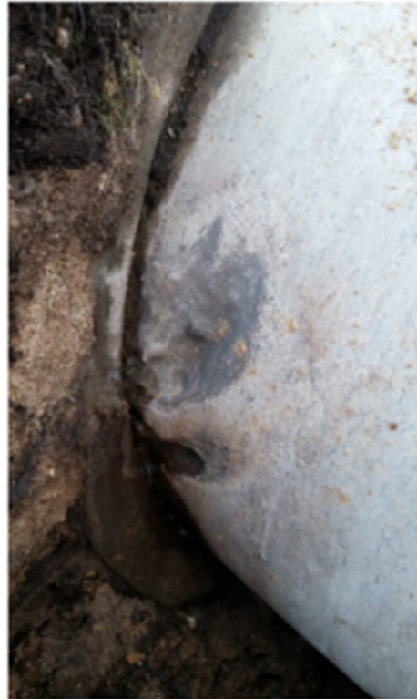
Foto 3. Beschadigde AC leiding door uitspoel drinkwater (foto Vitens)
