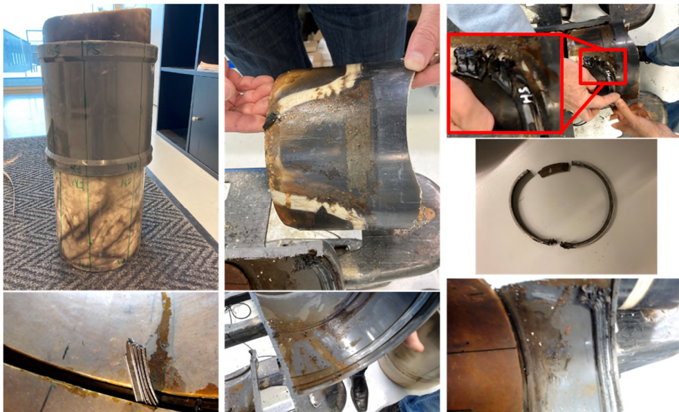
Figuur 22: (Linksboven) Gestoorde korte grijze mof (Linksonder) Rubberring die uitsteekt vanuit zijn voeg (Midden boven) Indruk van rubberring op de buis (Midden onder) Indruk van de rubberring op de mof (Rechtsboven) Verslijting op de rubberring en zijn ligging op de buis (Rechts midden) Beschadigde rubberring (Rechtsonder) Slijtage op de rubberring op de mof.
