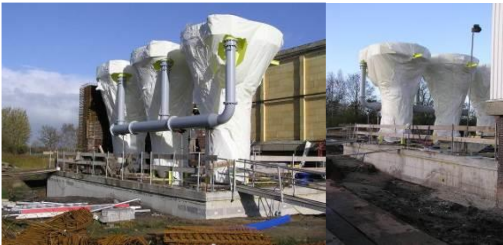
Foto 2.2.6 Inbouw van ingepakte pelletontharders op een drinkwaterproductielocatie (foto's Vitens).
