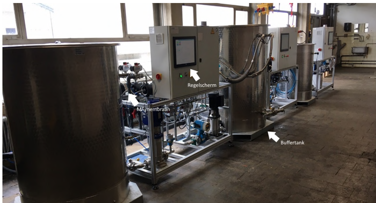
Figuur I-7 Fractioneringopstelling geplaatst in Andijk
