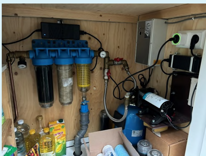
Figuur 12: impressie van de waterbehandelingsinstallatie bij een tiny house in Katwijk en de recirculatiedouche in de woning.
