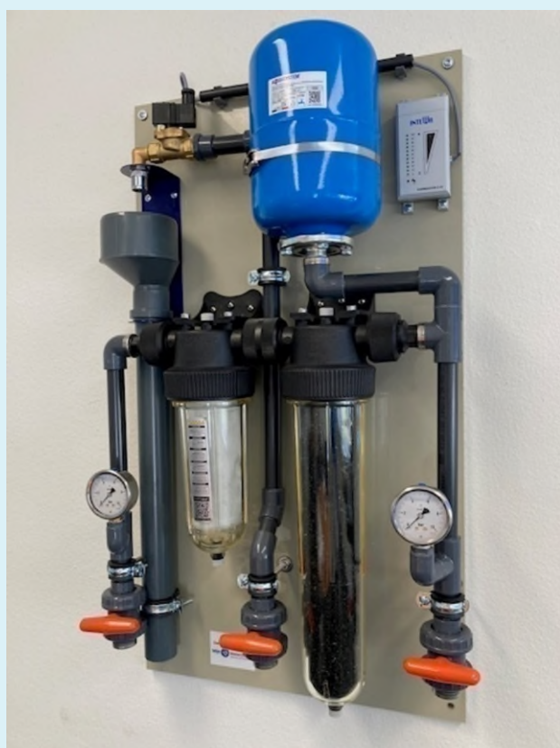
Figuur 10: model-installatie van Mijn Waterfabriek voor de productie van comfortwater uit opgevangen regenwater
