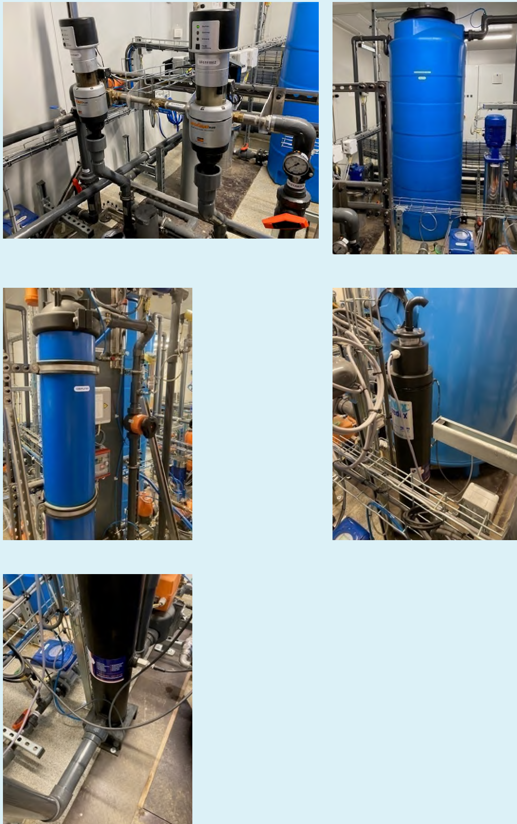
Figuur 18: onderdelen zuiveringsproces regenwater in Superlocal. Links boven kaarsenfilters, rechts boven opslagtank, midden links UF-module, midden rechts UVOX-reactor, links beneden actieve koolfilter.
