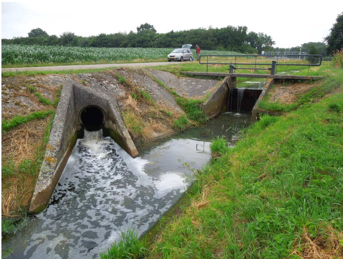
Afbeelding 2. Voeding van de Bolscherbeek met effluent van RWZI Haaksbergen (links) is in de zomerperiode groter dan de natuurlijke basisafvoer (rechts).
