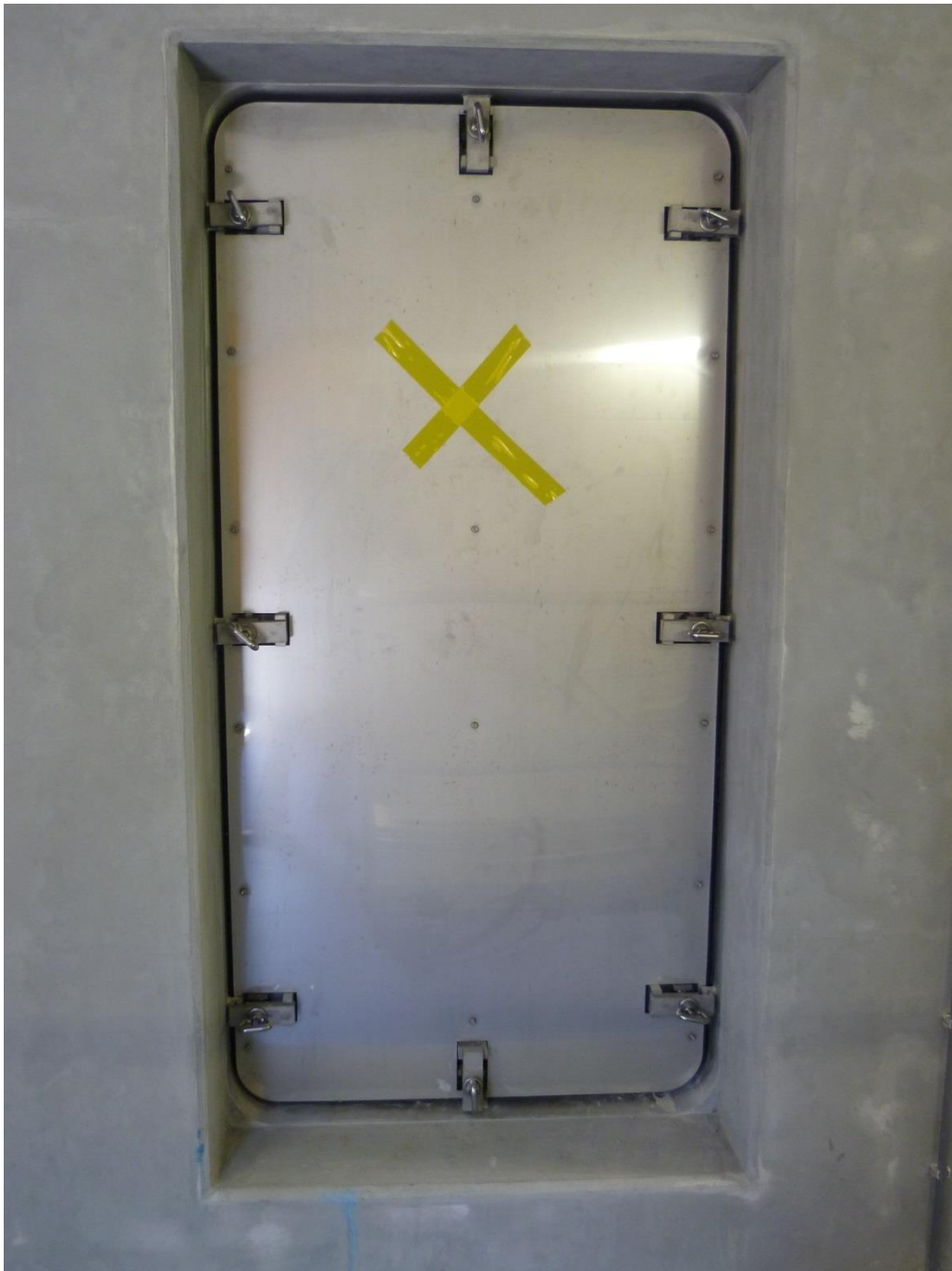
Figuur 9 Waterdichte deur in een drinkwaterreservoir.
