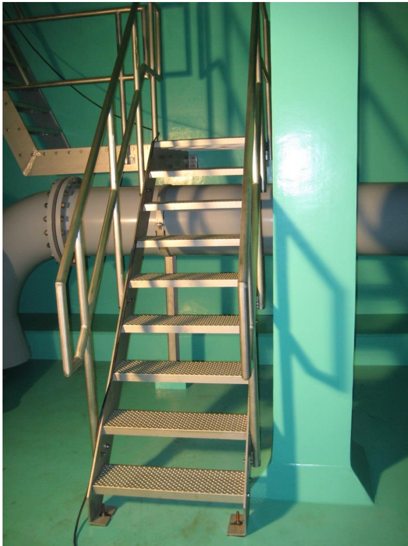
Figuur 10 Roestvaststalen trap in een drinkwaterreservoir.
