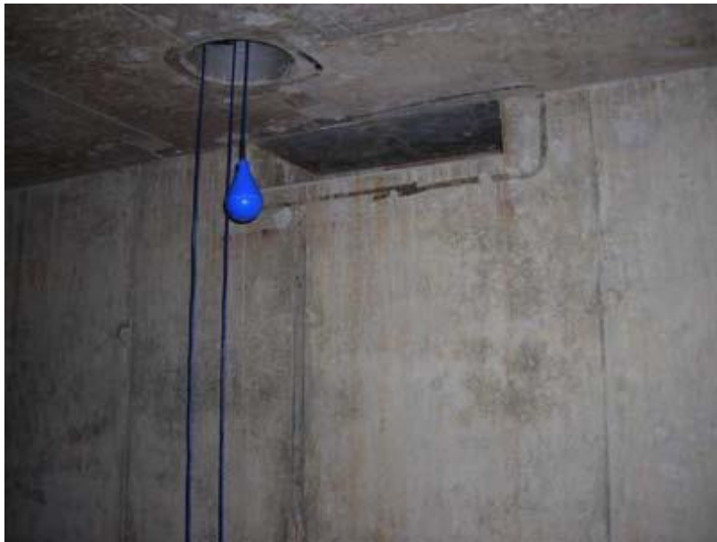
Figuur 13 Overloop van een drinkwaterreservoir met hoogniveaumeting.
