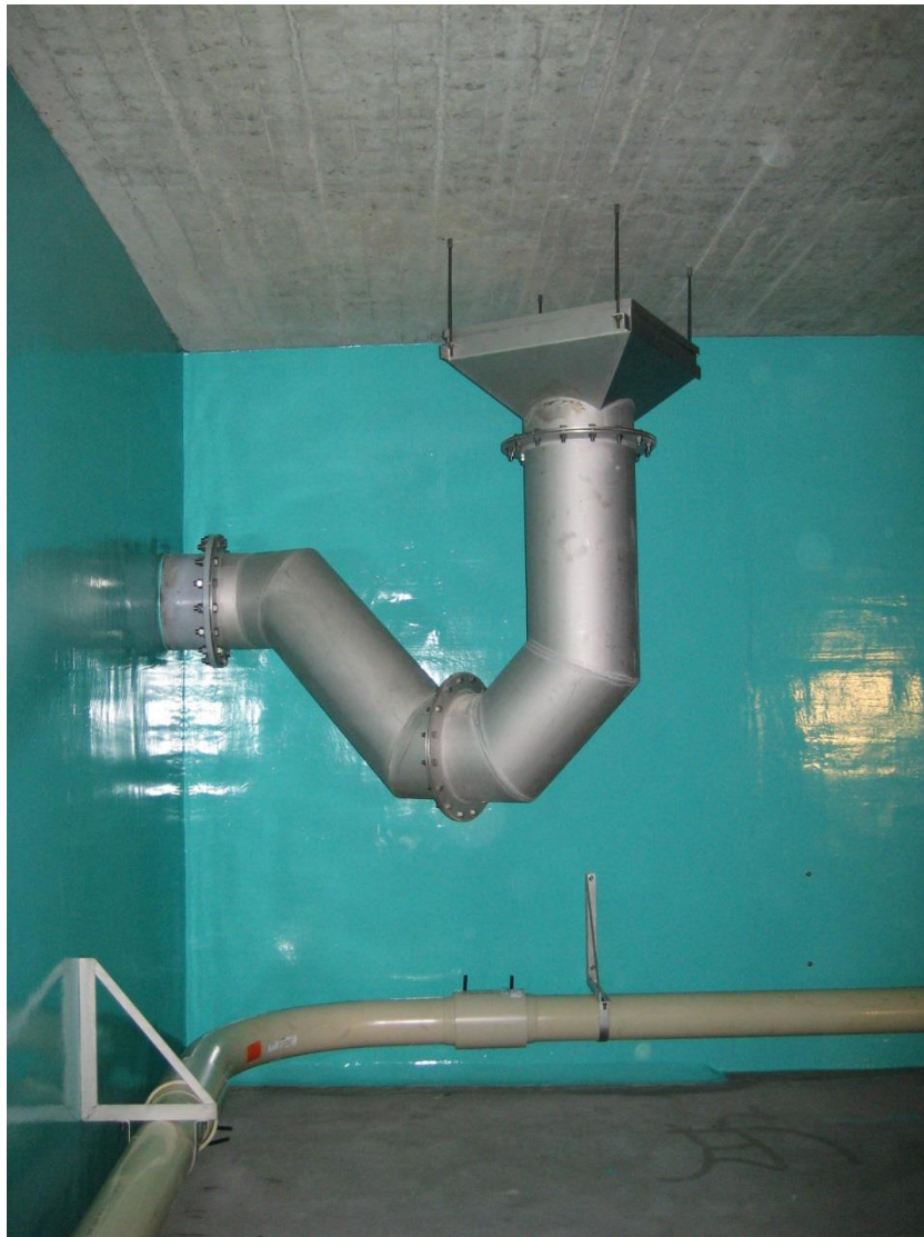
Figuur 11 Voorbeeld van een toevoerleiding (bovenste).
