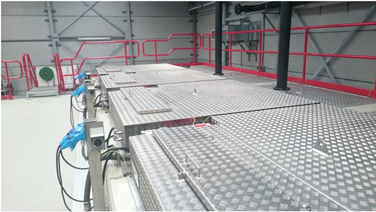
Foto 3: Fijnzeefstraat, waarin 4 fijnzeven zijn opgesteld onder de afdekkingsluiken
