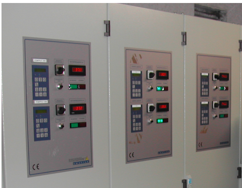
figuur 6: Schakelbord pompstation Nuland (foto Brabant Water)
