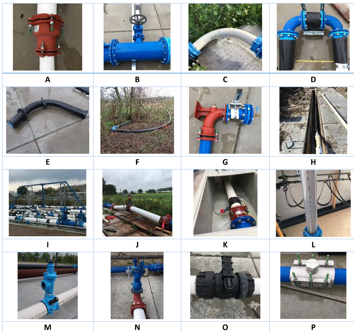
Afbeelding 3. Diverse details van de proefinstallatie van KWR. A) multi-jointkoppeling met diameterovergang, B) T-stuk met verloop, C) PVC-bocht, D) gietijzeren bocht, E) PE-bocht, F) verbogen PE-leiding, G) horizontale voetbocht, H) zinker, I) kattenrug, J) installatie voor hoekverdraaiing, K) lekbak voor leidingen met lekkage, L) transparante leiding met sediment, M) huisaansluiting, N) brandkaan, O) lock-jointkoppeling, P) reparatieklem
