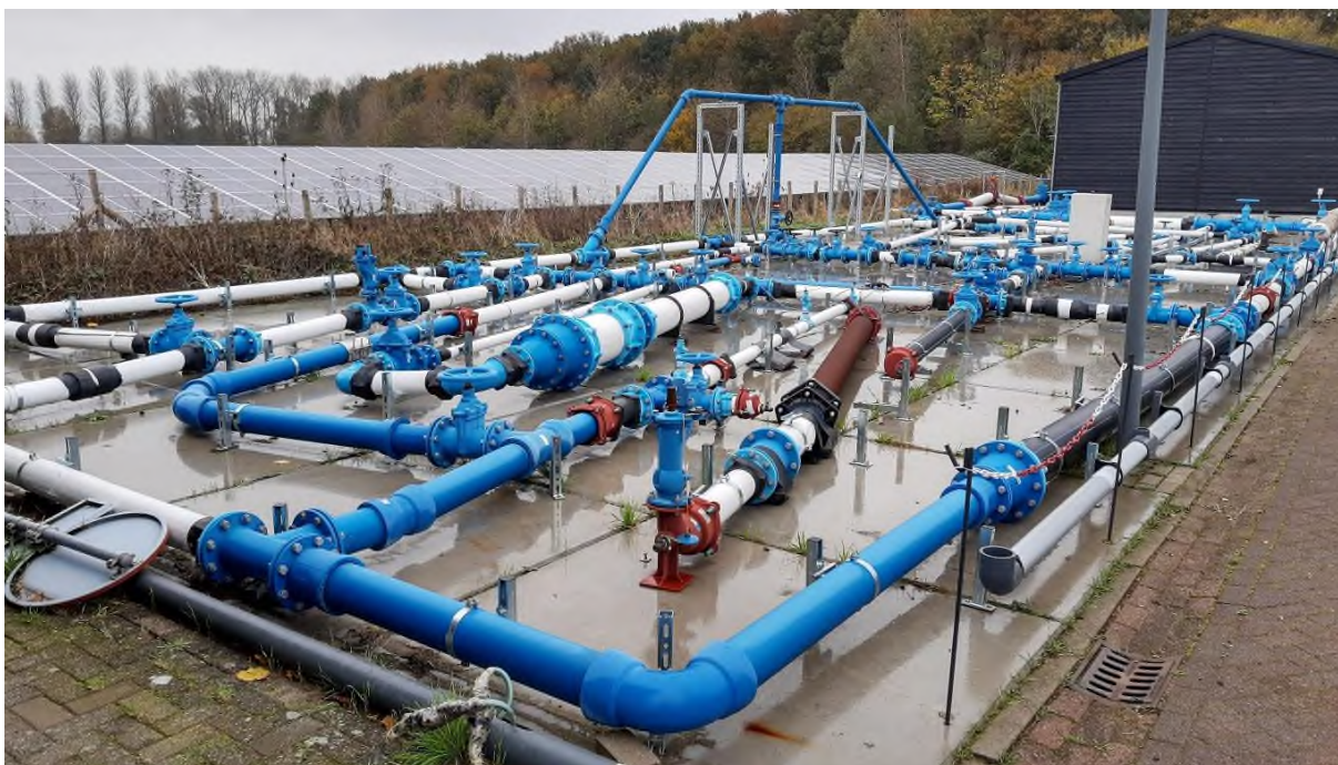
Afbeelding 1. Impressie van het buitengedeelte van de proefinstallatie. Het binnengedeelte bevindt zich in het gebouw rechts op de foto
