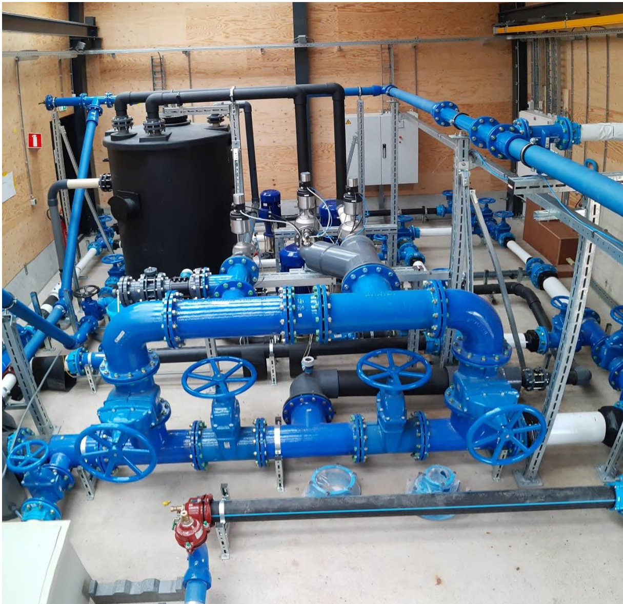
Afbeelding 2. Het binnengedeelte van de proefinstallatie
