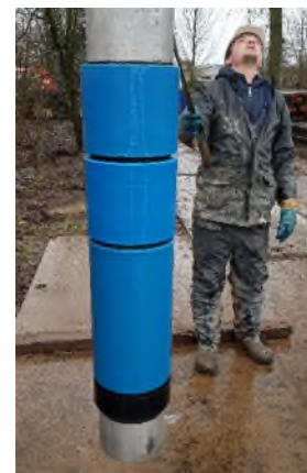
Figuur 36-1 Voorbeeld van een scheur in een HDDW op drinkwaterproductielocatie Meijendel (Dunea) vóór (links) en ná reparatie met een zelfspannende RVS-clip midden). Rechts een demonstratie van een reparatie met zwelrubber (QRS seal van firma Boode, die vooralsnog niet over de vereiste erkende kwaliteitsverklaring beschikt).
