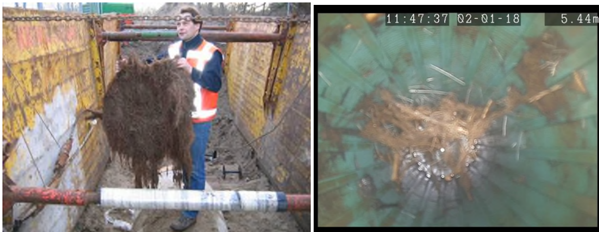
Figuur 32-15 Voorbeeld van wortelingroei in een drain (links) en camerabeelden van wortel in verticale put (rechts, foto Dunea).
