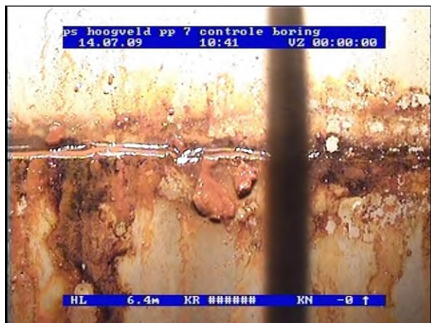
Figuur 32-16 Voorbeeld van 'microbial induced corrosion' op de las van een RVS casing (foto: R. Prevoo, WML).
