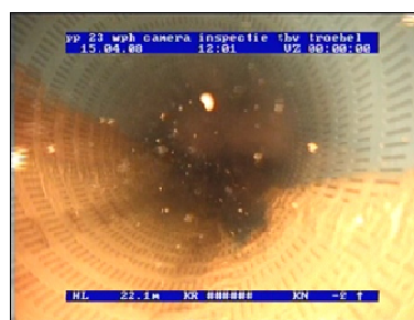
F. IJzerverstopping aan één zijde van de put
